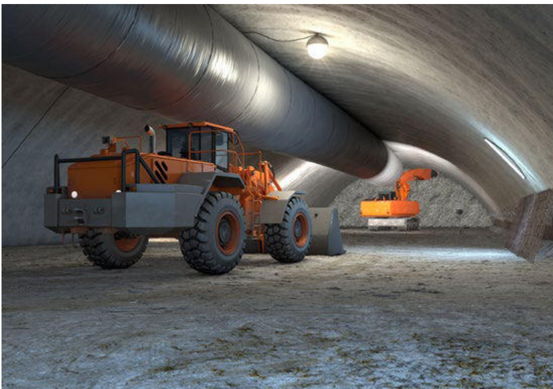
Abb. 141 Belüftung im Kalottenvortrieb
