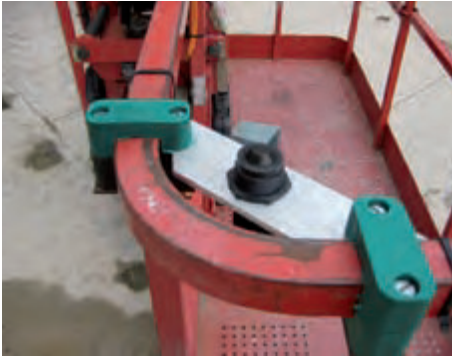
Bild 6-5: Absicherung von Bedienpult und Geländer durch Sensortechnik
